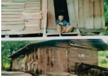
ก่อนซ่อม
