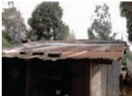
ก่อนซ่อม
