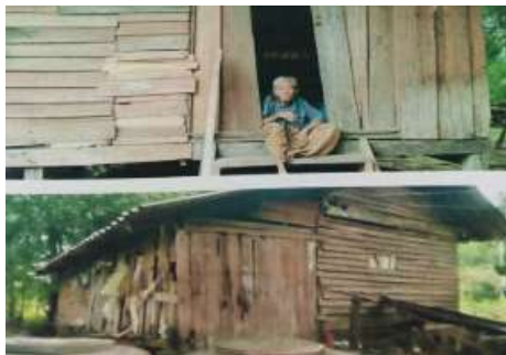
ก่อนซ่อม
