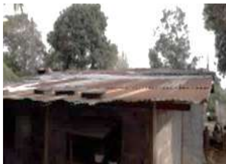
ก่อนซ่อม
