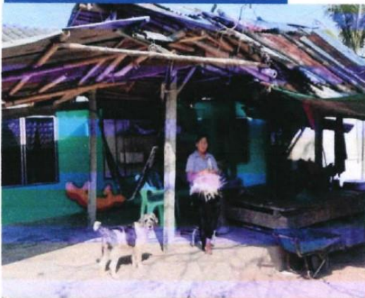
ก่อนซ่อมแซม
